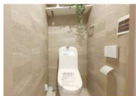
温水洗浄便座付一体型トイレ
